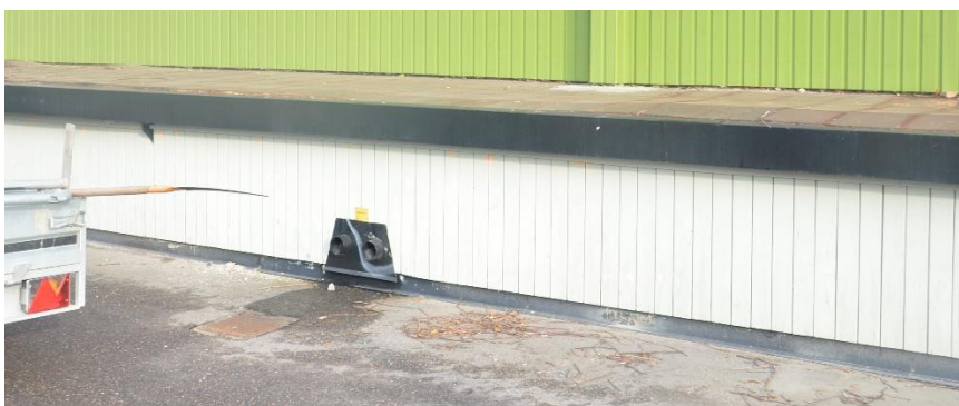
Figur 5. Utkastare från stuprören som dragits genom lastbryggan samt en dagvattenbrunn mindre än en meter framför.
